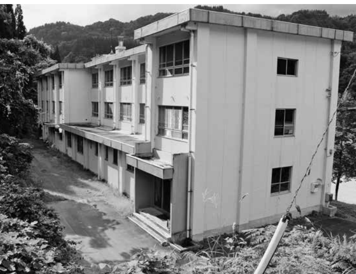
昭和51年開寮（築44年）の県寄宿舍 （寄宿舍内部は老朽化が進んでいます）
