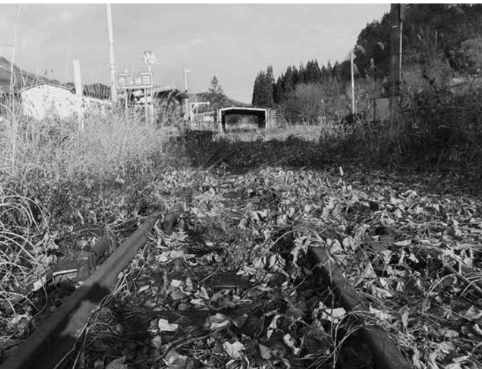
復旧が急がれる鉄道施設 会津横田駅（平成28年12月7日撮影）
