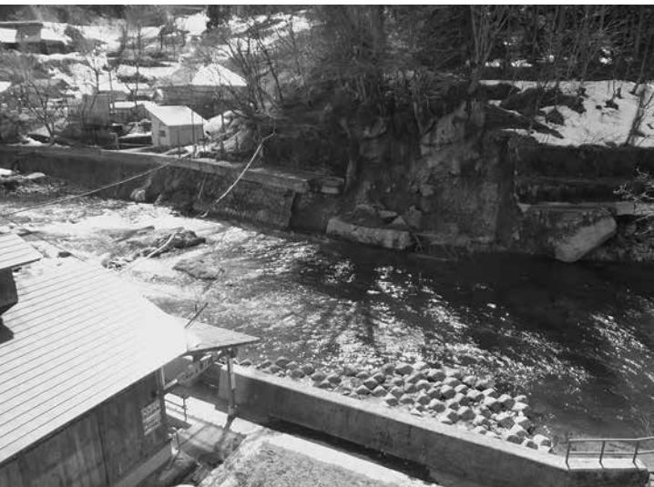
野尻川災害現場 護岸や河床が流出している
