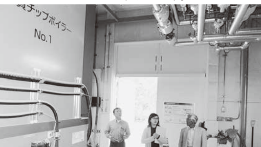
▲大型チップボイラー室の様子
