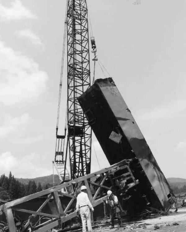
落橋したJR第7鉄橋の引揚現場 一緒に引き上げられた「滝ダム台船」
