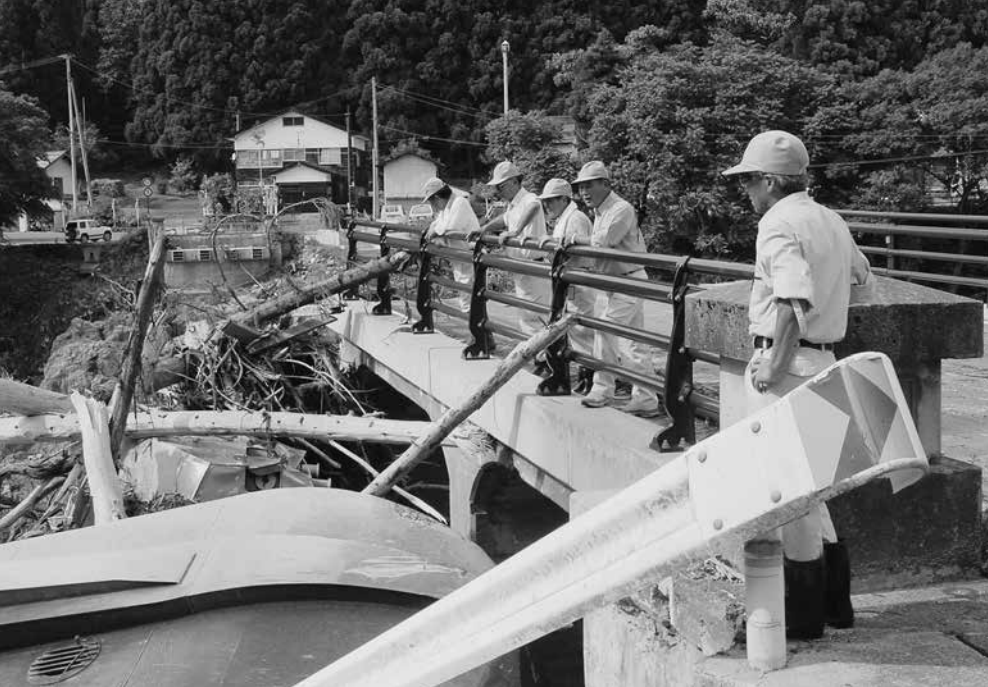
旧二本木橋の被害状況（手前に浚渫用台船が確認できる）H23年8月17日
