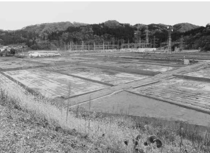
災害復旧が進められている本名の下タ原地区
