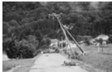
水害で被災した光ケーブル
