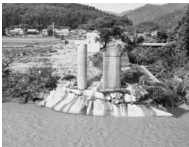
被災直後の田沢橋
