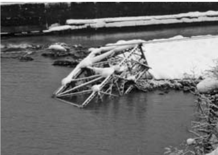
落橋したままのJR鉄橋 (写真は本名地内JR第6橋梁)
