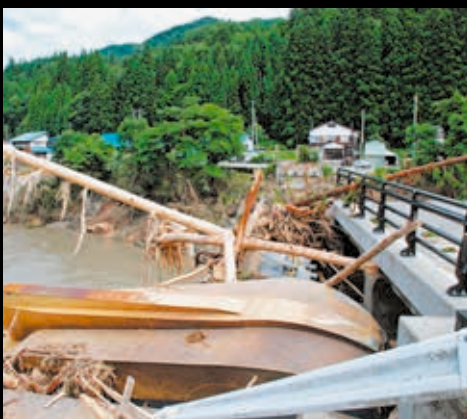
大洪水により流失した二本木橋（上横田）
