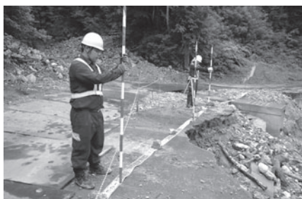
御神楽山へ続く林道の崩落現場
