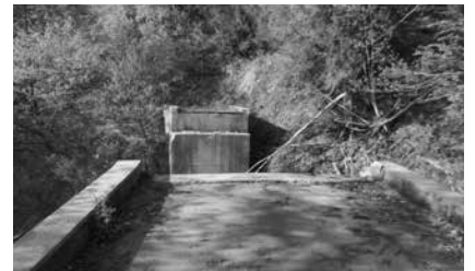
林道の落橋箇所
