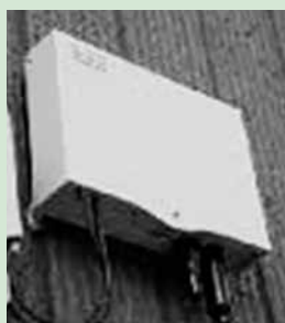
光電変換装置 （家の外にあります）
