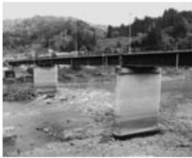
水位計が設置された西谷橋 (国道252号)
