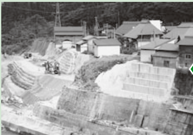
ダム放流により崩落した法面の工事が継続中である
