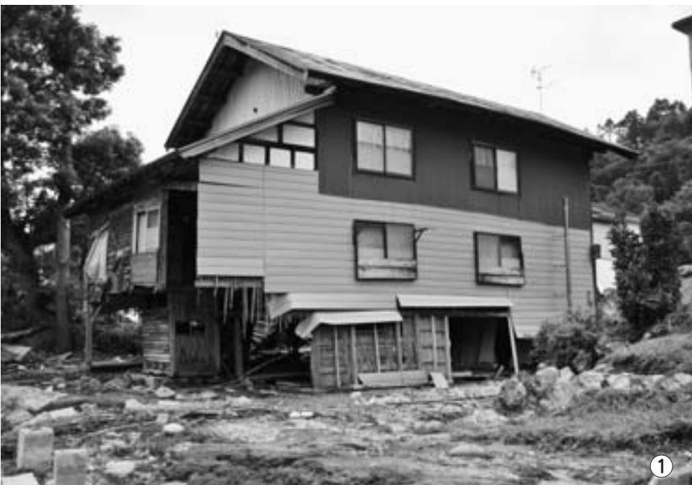
① 水の力で壁が流された家屋（上横田）
