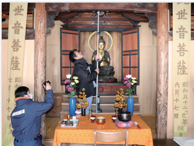
宮崎大悲堂の火災報知器が正常か確認中
