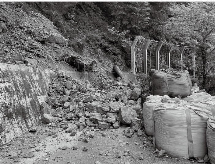
土砂崩落等により通行止の県道小栗山宮下線 現地での安全な通行確保のため対策工事中 再開通予定は令和7年5月頃になります。
