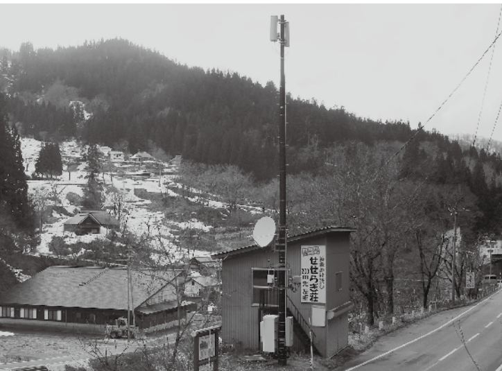
整備中のWi-Fi基地局 40基の内37基が完成しています(玉梨地内)
